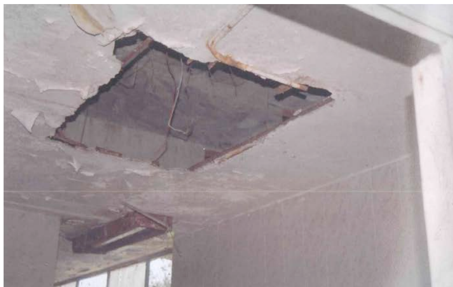
Foto 24, tomada en un baño del C.A.I.S., "Cuemanco" el 10 de febrero de 2012, donde se observa el deterioro de las instalaciones.
