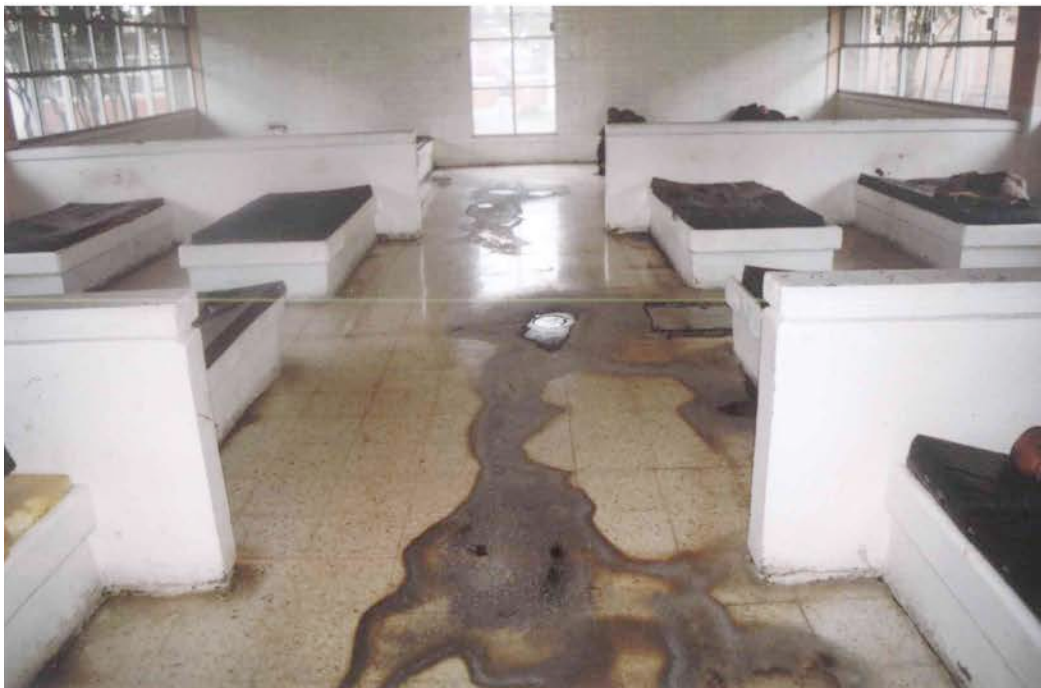
Foto 22, tomada en un dormitorio del C.A.I.S., "Cuemanco" el 10 de febrero de 2012, donde se observa el deterioro de las instalaciones.
