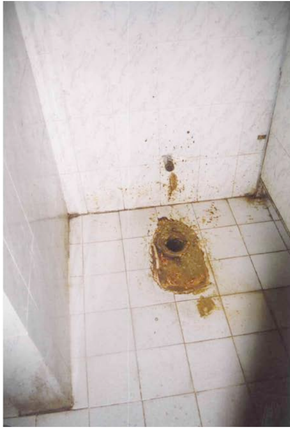
Foto 19, tomada en el área de baños del dormitorio del C.A.I.S., "Cuemanco" el 10 de febrero de 2012, donde se observa que en los sanitarios no hay retrete y hay abundante materia fecal.
