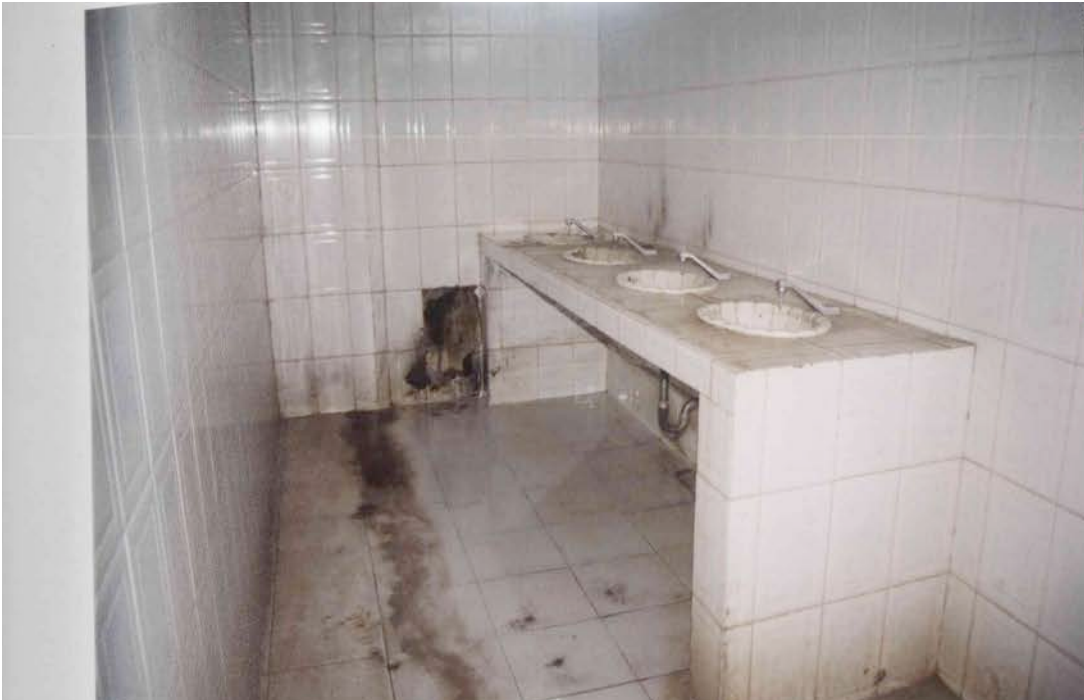
Foto 21, tomada en un baño de dormitorio del C.A.I.S., "Cuemanco" el 10 de febrero de 2012, donde se observa el deterioro de las instalaciones.
