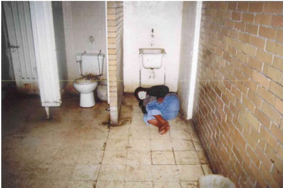
Foto 38, tomada en el área de baños del C.A.I.S. "La Cascada", el 10 de febrero de 2012, en donde se observa a una usuaria recostada debajo de un lavabo. Al lado se observa uno de los sanitarios con materia fecal.
