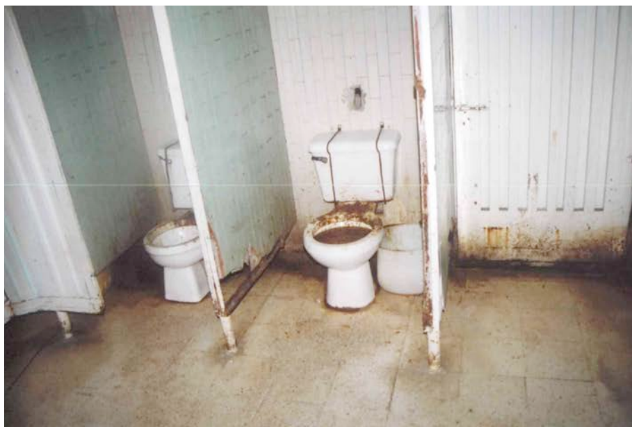
Foto 11, tomada en el área de baños del dormitorio del C.A.I.S., "La Cascada" el 10 de febrero de 2012, donde se observa que en los sanitarios hay abundante materia fecal.
