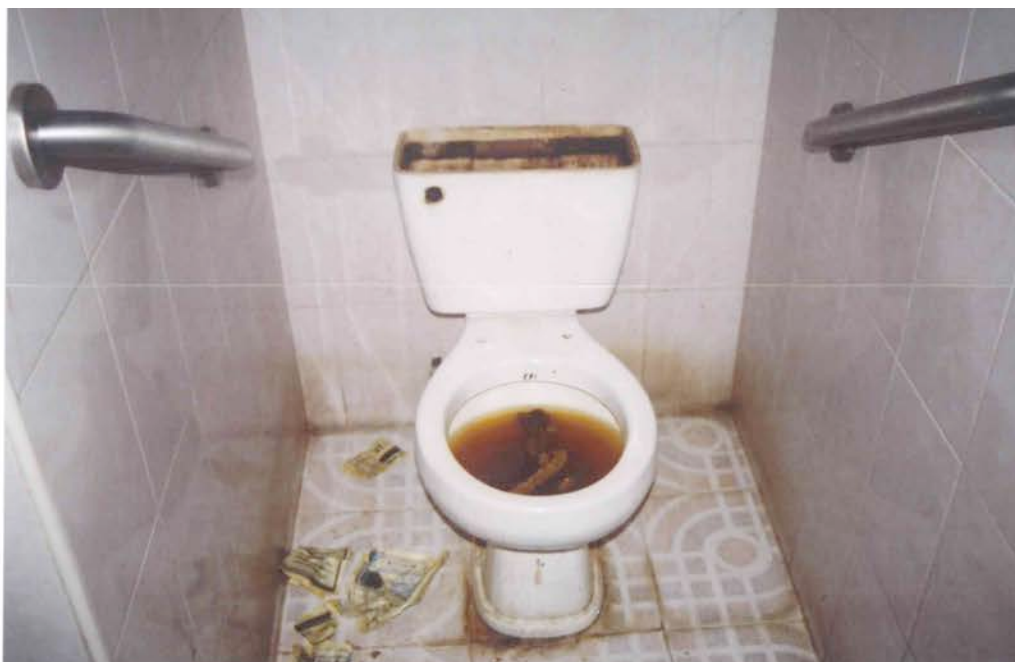
Foto 9, tomada en el área de baños del dormitorio del C.A.I.S., "La Cascada" el 10 de febrero de 2012, donde se observa que en los sanitarios hay abundante materia fecal.
