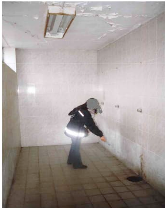
Foto 6, tomada en el área de baños del dormitorio del C.A.I.S., "La Cascada" el 10 de febrero de 2012, donde se señala que en las regaderas hay materia fecal.
