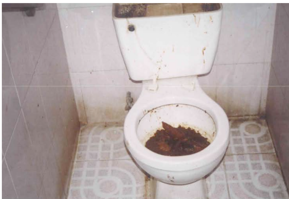
Foto 8, tomada en el área de baños del dormitorio del C.A.I.S., "La Cascada" el 10 de febrero de 2012, donde se observa que en los sanitarios hay abundante materia fecal.
