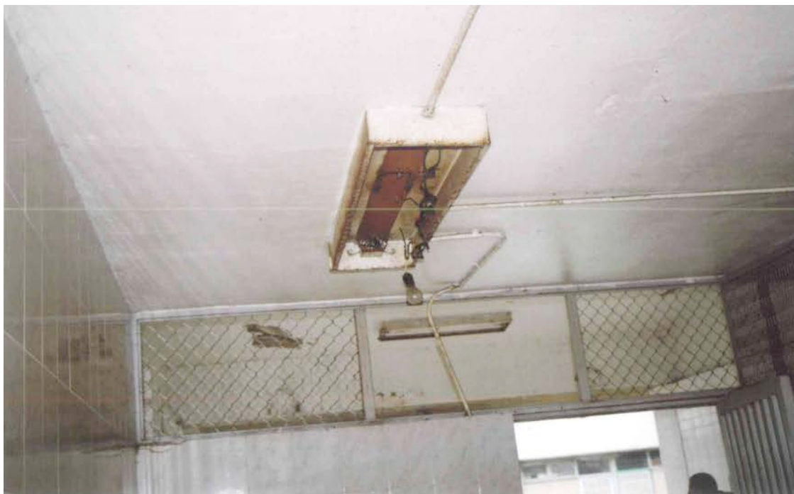
Foto 27, tomada en un baño del C.A.I.S., "Cuemanco" el 10 de febrero de 2012, donde se observa el deterioro de las instalaciones.
