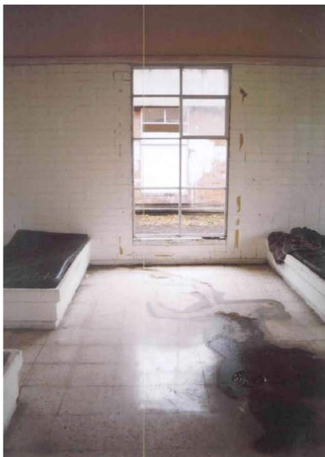
Foto 23, tomada en un dormitorio del C.A.I.S., "Cuemanco" el 10 de febrero de 2012, donde se observa el deterioro de las instalaciones.
