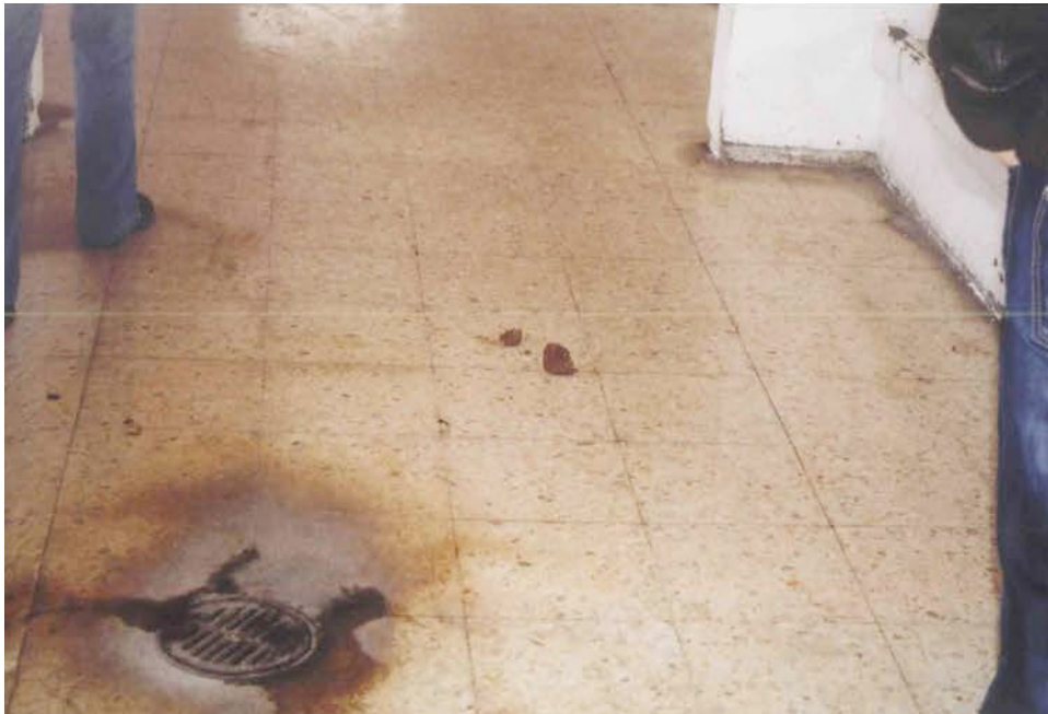
Foto 20, tomada en el área de dormitorio del C.A.I.S., "Cuemanco" el 10 de febrero de 2012, donde se observa materia fecal en el pasillo.
