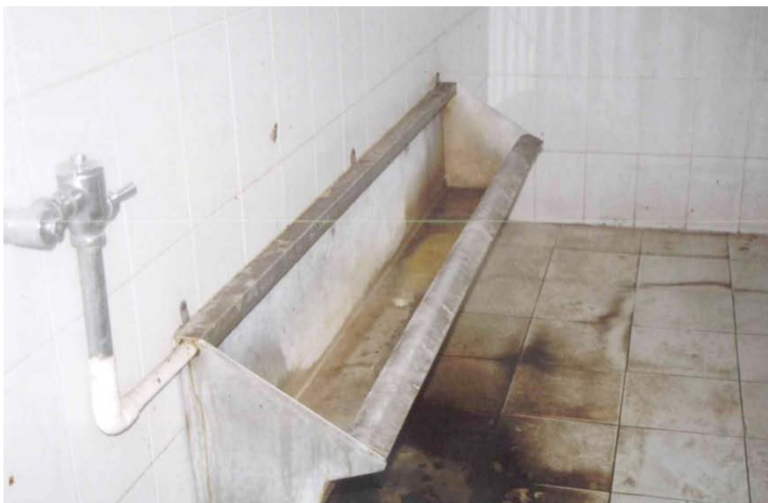
Foto 28, tomada en un baño del C.A.I.S. "Cuemanco", el 10 de febrero de 2012.
