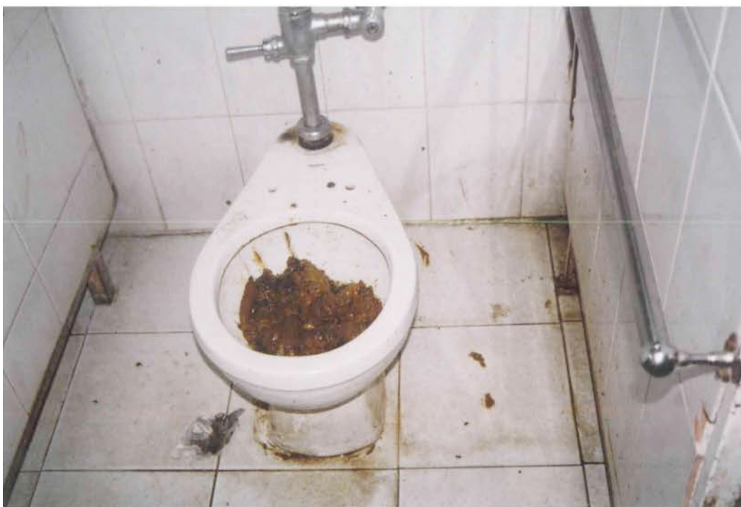
Foto 7, tomada en el área de baños del dormitorio del C.A.I.S., "La Cascada" el 10 de febrero de 2012, donde se observa que en los sanitarios hay abundante materia fecal.
