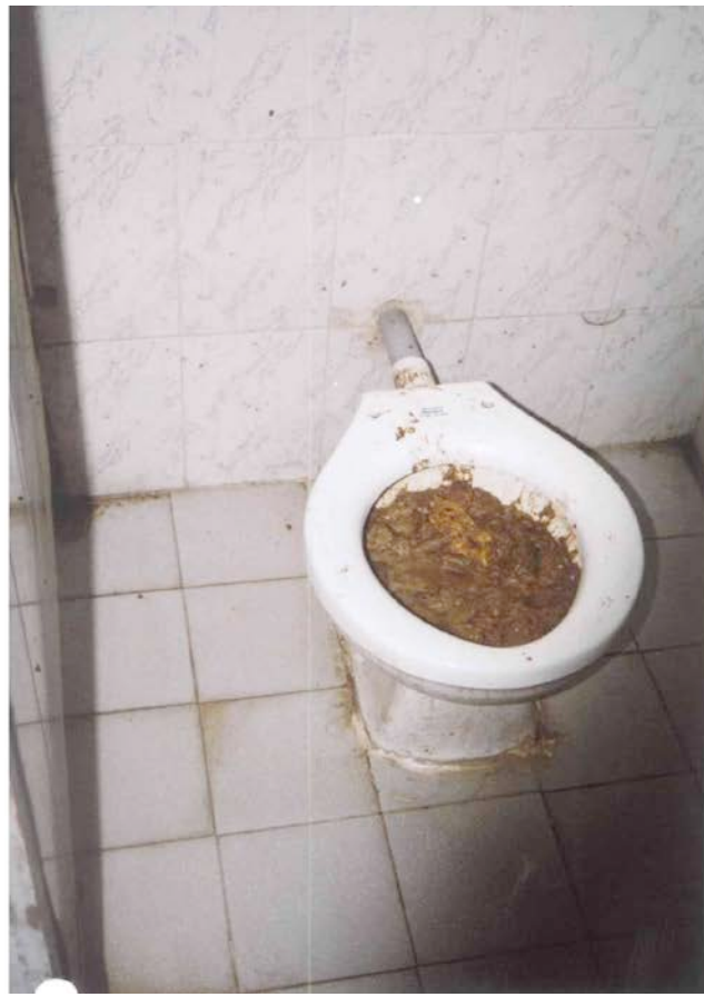
Foto 18, tomada en el área de baños del dormitorio del C.A.I.S., "Cuemanco" el 10 de febrero de 2012, donde se observa que en los sanitarios hay abundante materia fecal.
