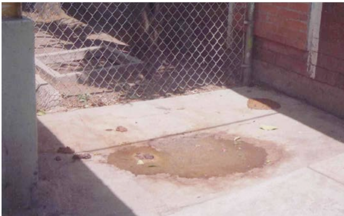
Foto 4, tomada en el C.A.I.S., "La Cascada" el 1 de abril de 2011, donde se aprecia el Patio de ese Centro con materia fecal.
