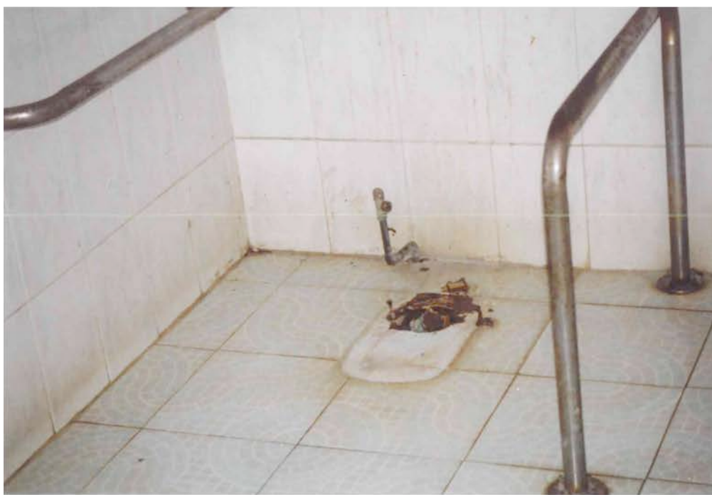
Foto 12, tomada en el área de baños del dormitorio del C.A.I.S., "La Cascada" el 10 de febrero de 2012, donde se observa que no hay retretes en los baños.
