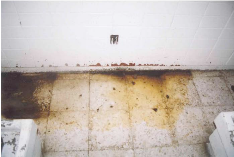
Foto 29, tomada en un dormitorio del C.A.I.S. "Cuemanco", en la que se observa materia fecal, del 10 de febrero de 2012.
