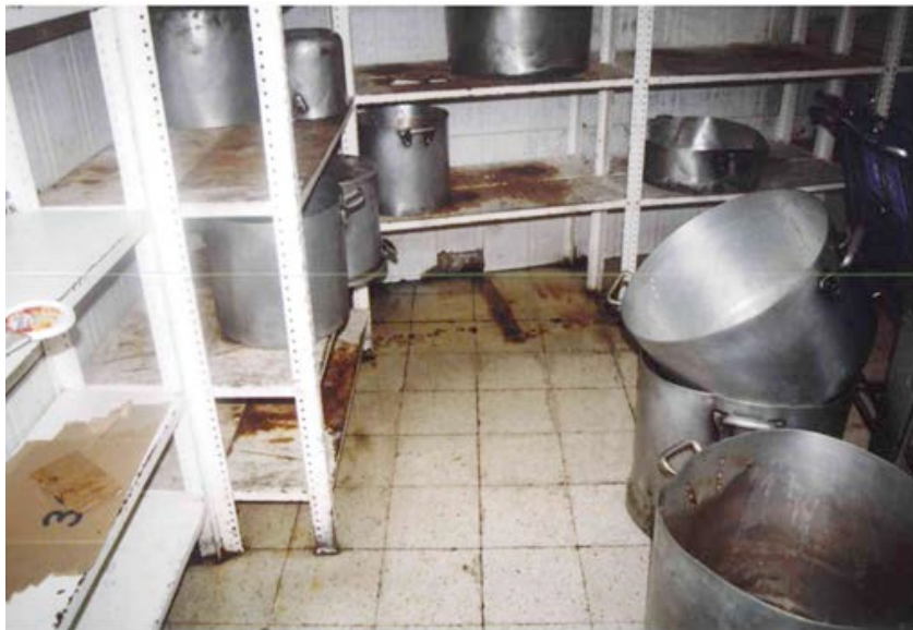
Foto 15, tomada en un el área de Cocina del C.A.I.S., "La Cascada" el 10 de febrero de 2012, donde en el piso en el fondo de la imagen se observa encharcamiento derivado de una fuga de agua.
