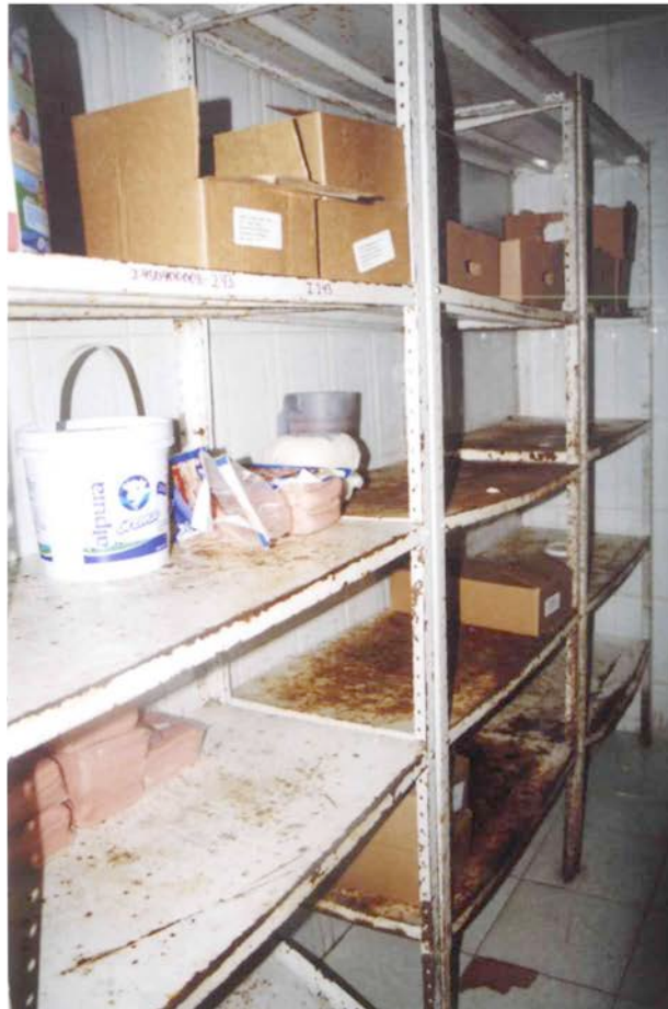
Foto 16, tomada en un el área de Cocina del C.A.I.S., "La Cascada" el 10 de febrero de 2012, donde se observa un anaquel deteriorado y poca comida.
